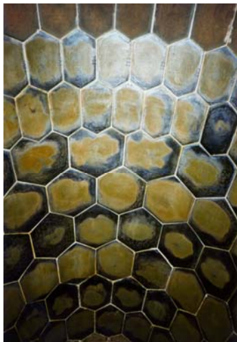
Čedičové vyložení cyklónu v cementárně
